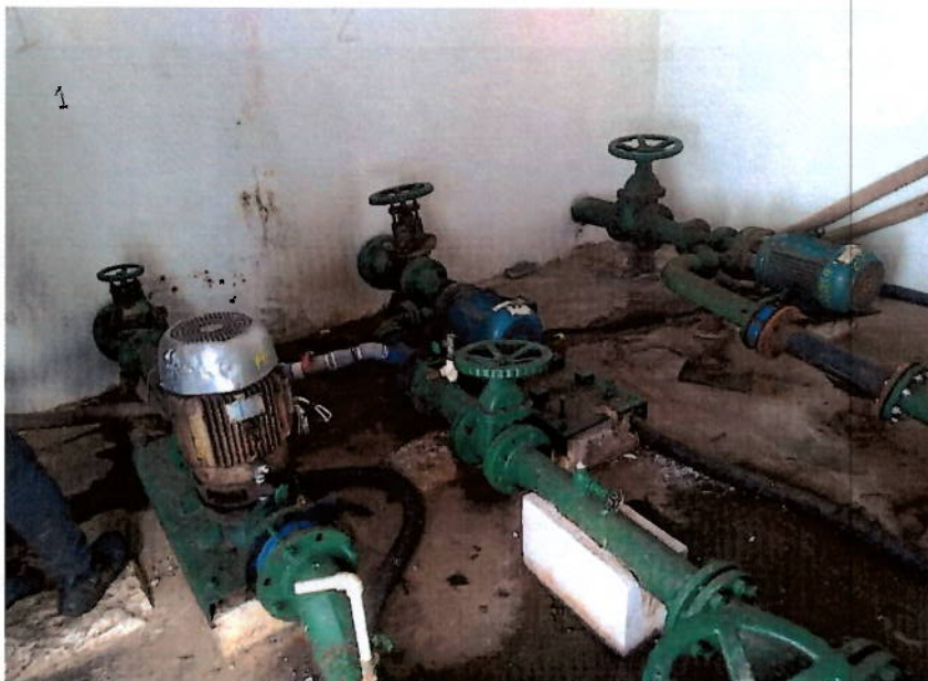
Foto 25 – sistema motobombas da EEAT de Mangaratiba.
