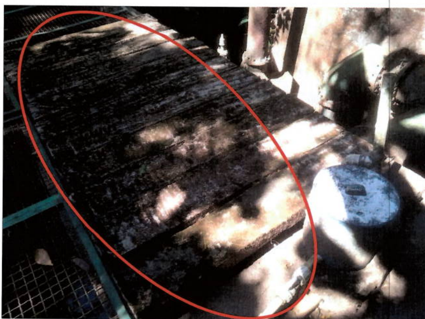
Foto 13 – Tampa do tanque de cloração (não oferece estanqueidade para proteção da água clorada).
