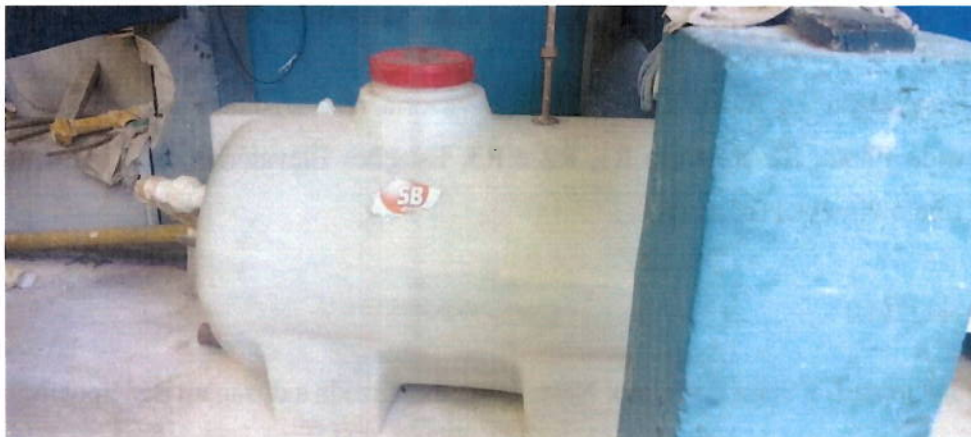
Foto 3 – sistema de cloração com Hipoclorito de Cálcio.
