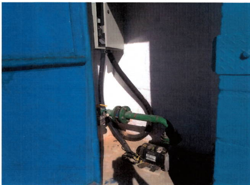
Foto 31 – Booster utilizado para abastecer a parte alta de Ibicuí.
