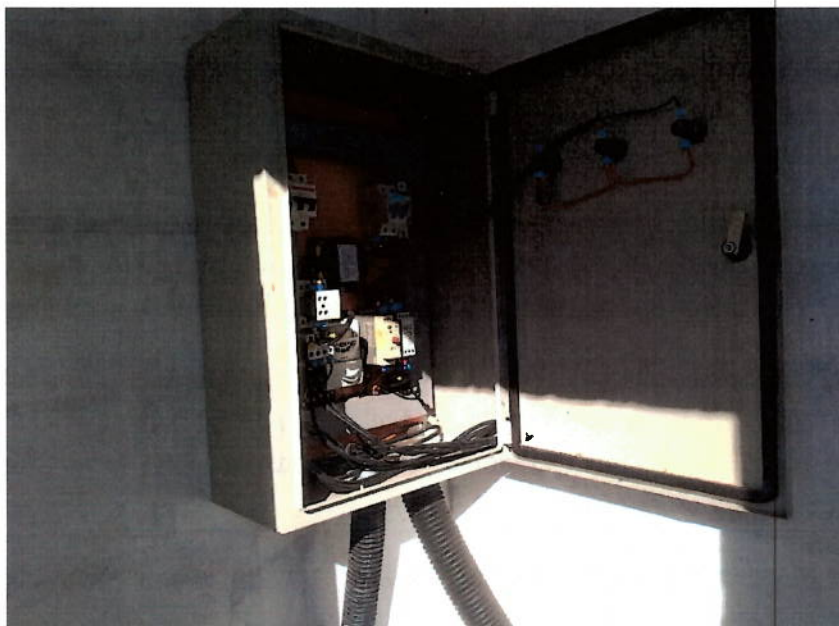
Foto 32 – Quadro elétrico do booster.
