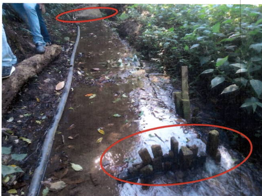
Foto 9 – vazamento no canal de concreto.
