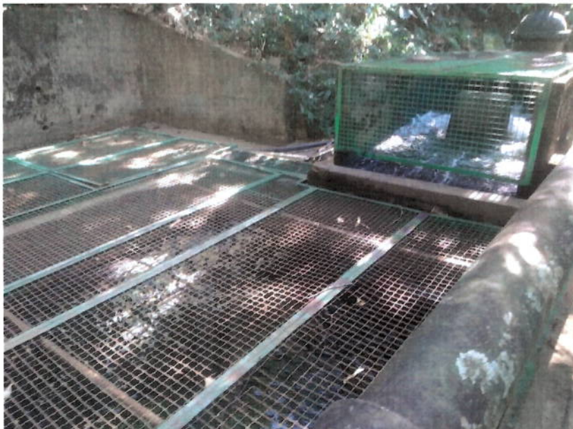
Foto 10 – caixa de areia.
