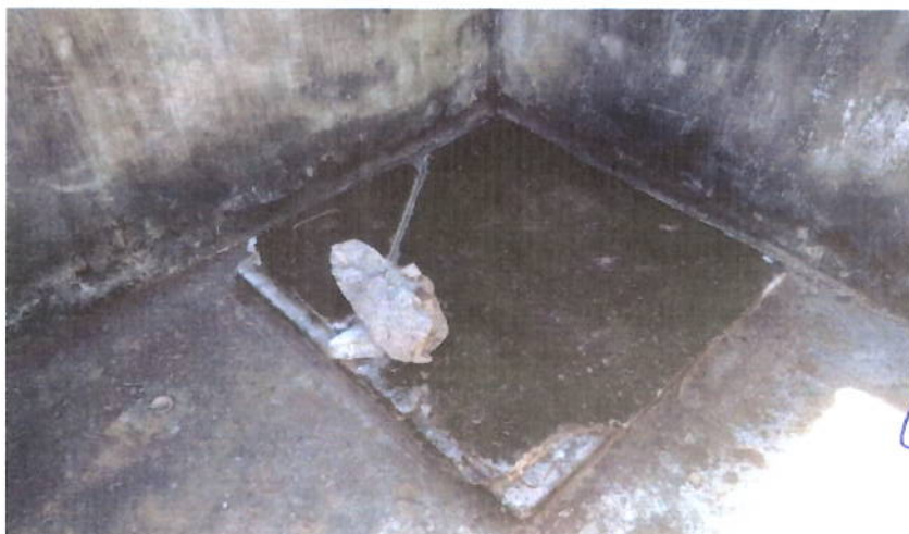
Foto 19 – Tampa de inspeção do Reservatório R1 (não oferece estanqueidade para proteção da água clorada).
