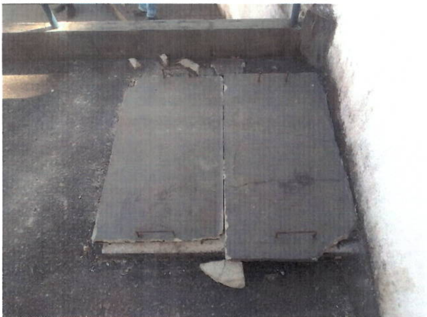
Foto 23 - Tampa de inspeção do Reservatório R2 (não oferece estanqueidade para proteção da água clorada).
