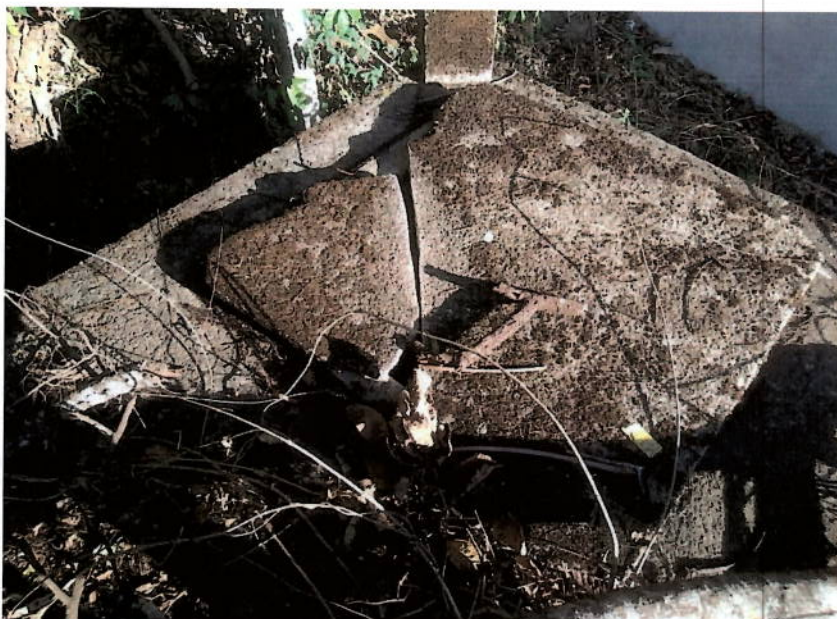
Foto 29 - Tampa de inspeção do Reservatório R3 (não oferece estanqueidade para proteção da água clorada).
