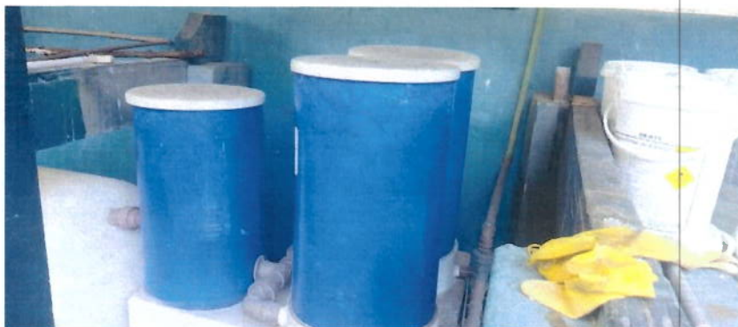
Foto 2 – sistema de cloração com Hipoclorito de Cálcio.
