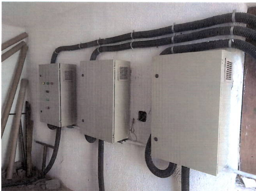
Foto 26 – Quadro elétrico do sistema motobomba.
